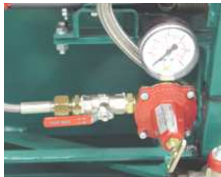
Vanne principale et détendeur réglé à 1,3 bar
